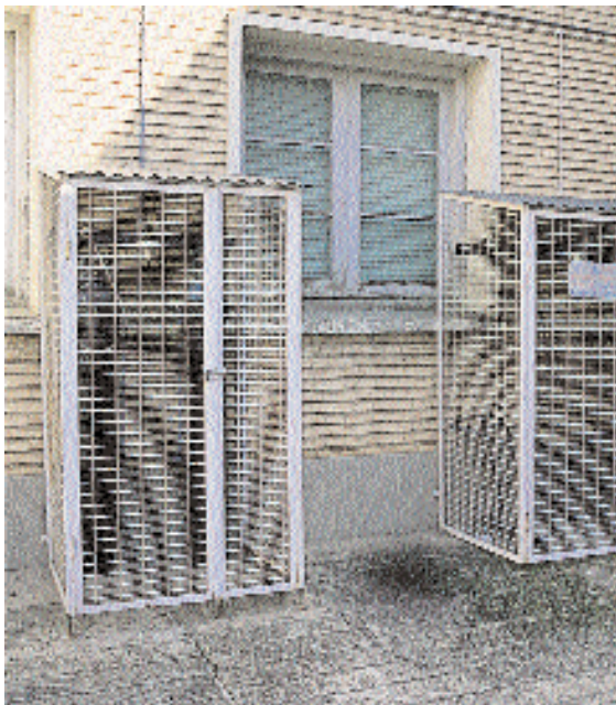
Fotografía 5. Central de gases. Debe situarse al aire libre y estar convenientemente señalizada.
