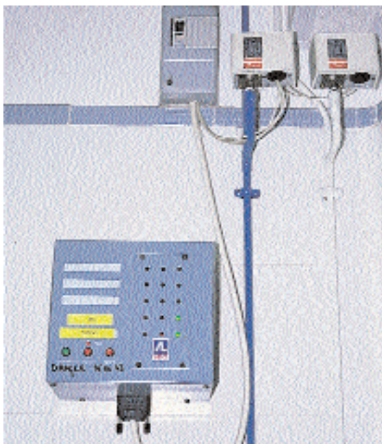
Fotografía 7. Alarma sonora y visual (presostato) localizada en el área clínica.
