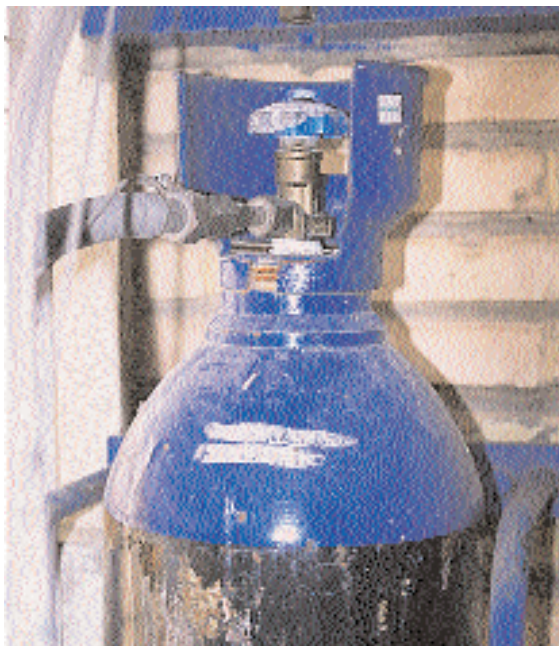
Fotografía 1. Bombona de óxido nitroso con la tulipa de color azul. La sujeción al armazón de la central de gases es una medida de seguridad para evitar su caída al suelo o sobre el manipulador.
